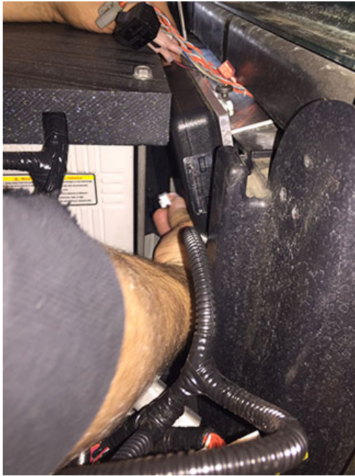
Fig. 20 - BMS power wires
