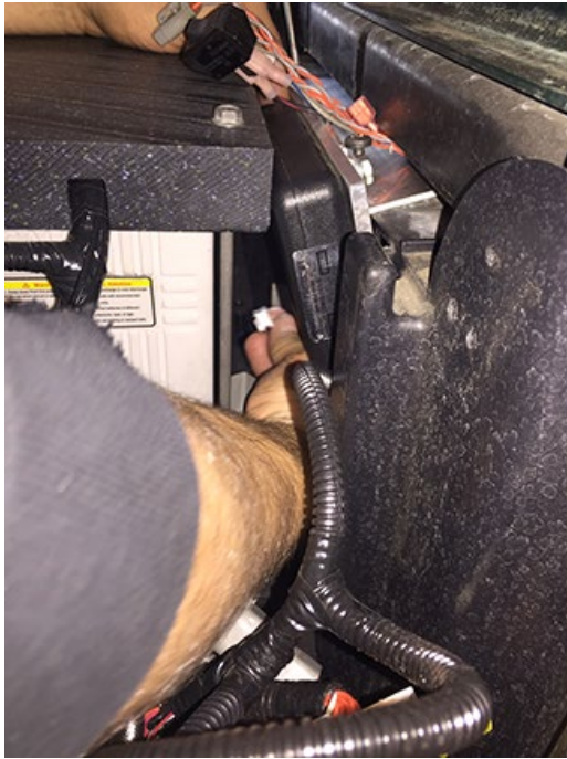
Fig. 20 - BMS power wires
